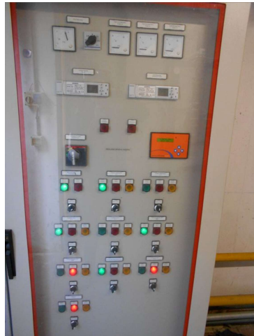
Figura 4.11 – Quadro centrale termica Scuola
