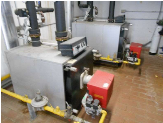
Figura 4.17 - Particolare delle caldaie
