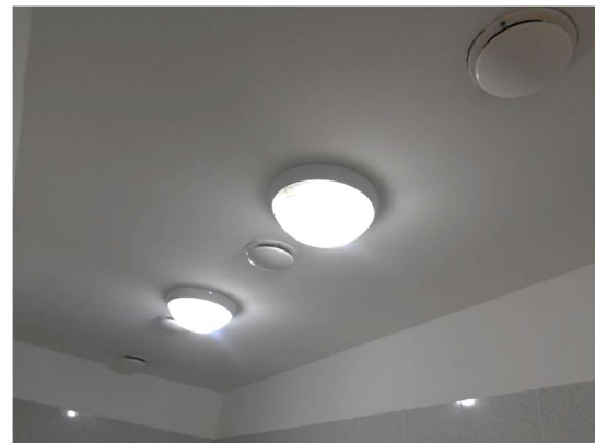
Figura 4.24 - Particolare dei corpi illuminanti ubicati nella Scuola dell'Infanzia
