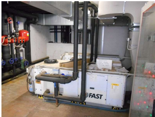
Figura 4.22 - Unità di trattamento aria
