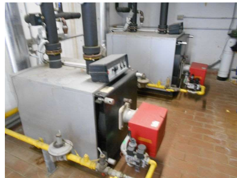
Figura 8.2 - Particolare dei generatori di calore
