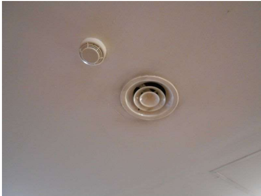
Figura 4.9 – Particolare delle bocchette di aerazione d'immissione a soffitto nella Scuola dell'Infanzia
