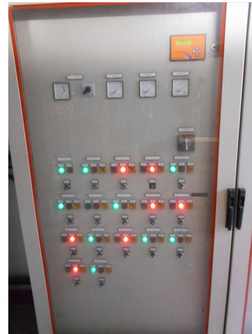
Figura 4.12 – Quadro centrale termica Biblioteca
