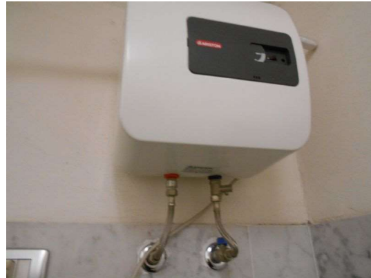
Figura 4.20 - Boiler elettrici Biblioteca
