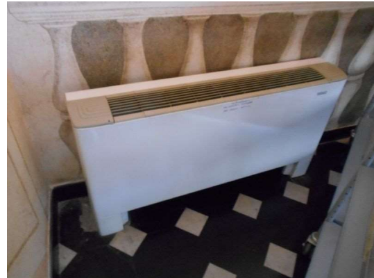
Figura 4.10 - Particolare ventilconvettori Biblioteca Lercari
