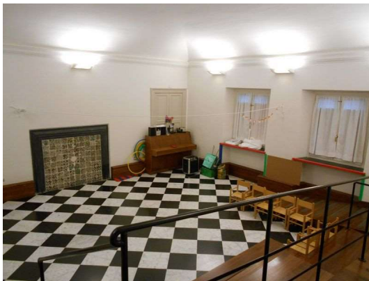
Figura 4.25 - Particolare dei corpi illuminanti ubicati nella Scuola dell'Infanzia
