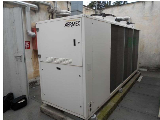
Figura 4.21 - Pompa di calore in copertura
