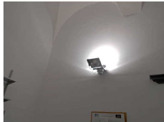
Figura 4.26 - Particolare dei corpi illuminanti ubicati nelle sale della Biblioteca
